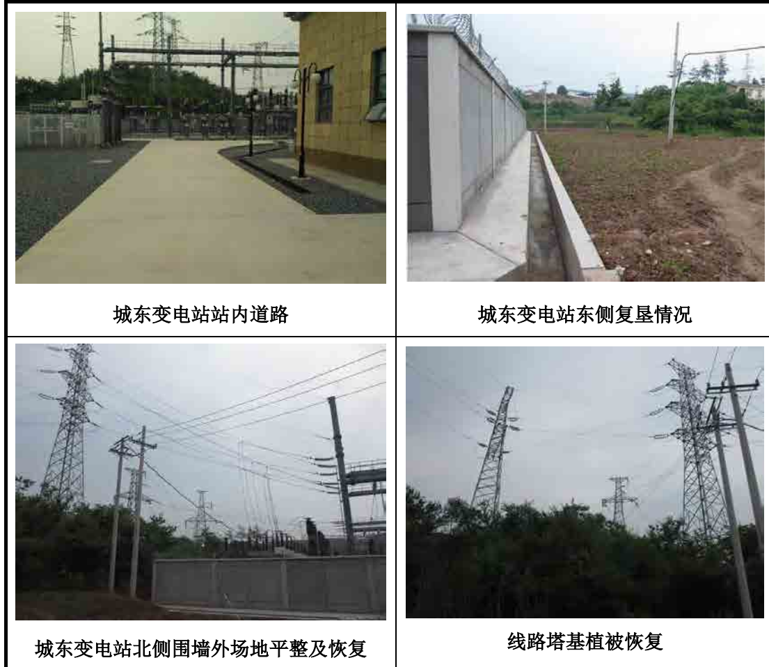
图 5 变电站及塔基周围恢复情况
