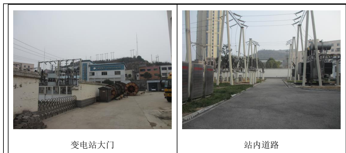
图2 110kV 宝塔河变站内现状
