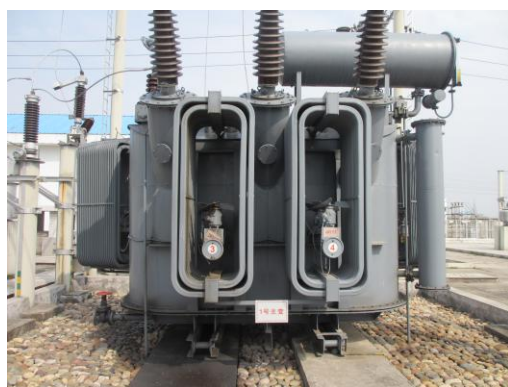
变电站 10MVA 1#主变（拟更换）
