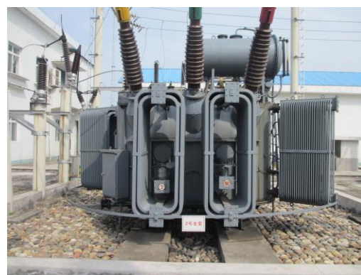
变电站 10MVA 2#主变
