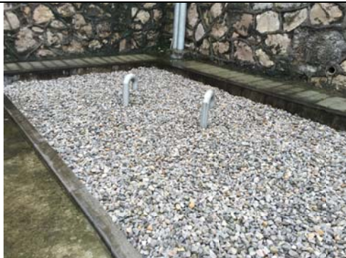
主变事故油池
