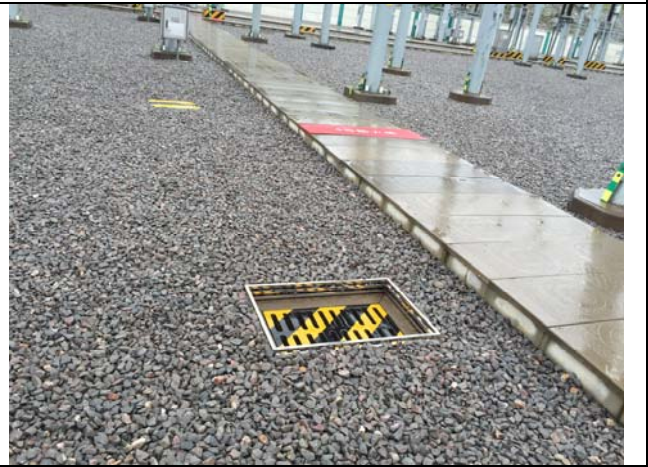
木店变内雨水井
