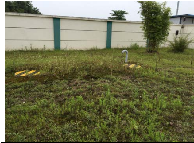
木店变内原有事故油池
