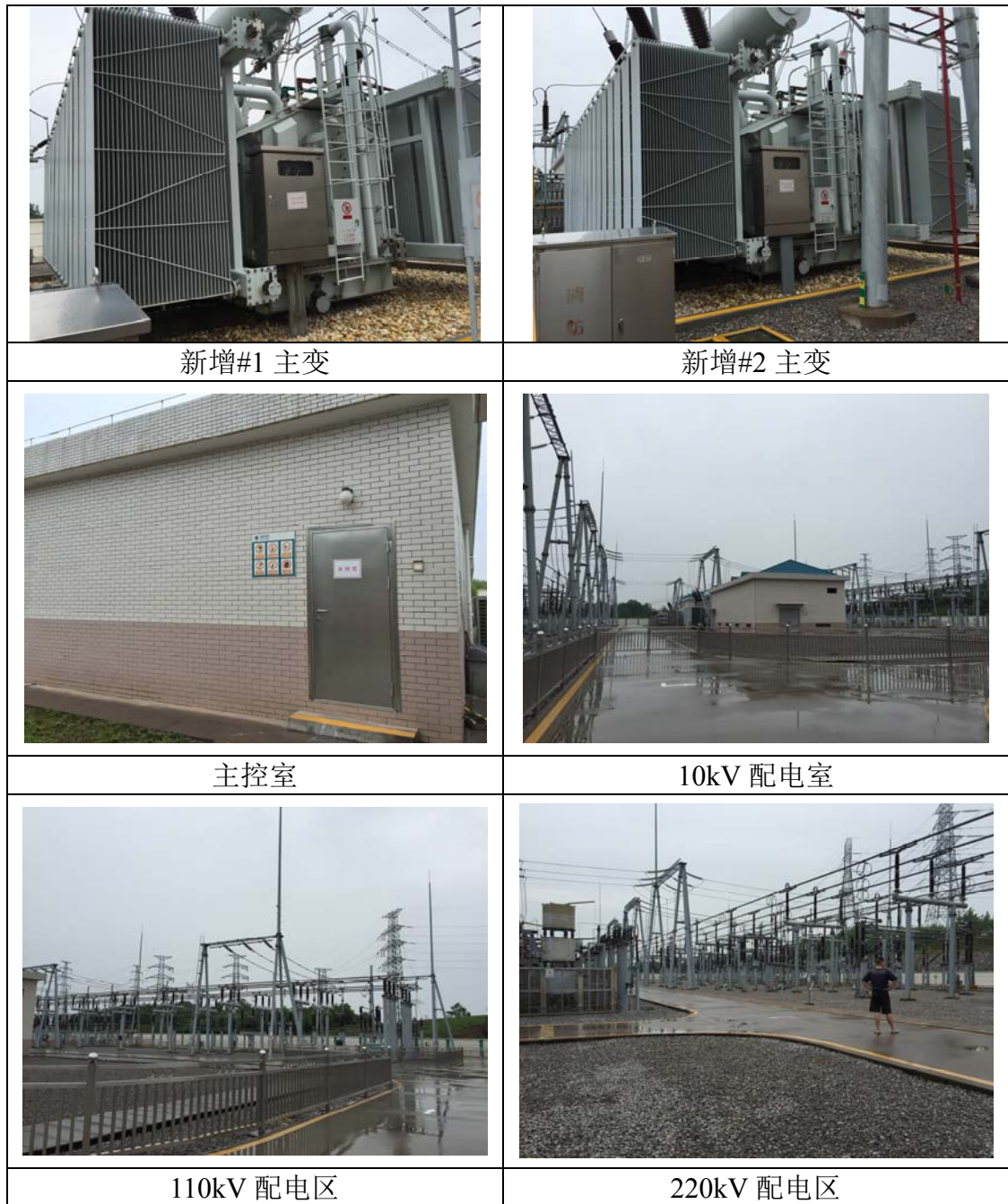
图 4-3 木店变电站本期工程主要设备情况
