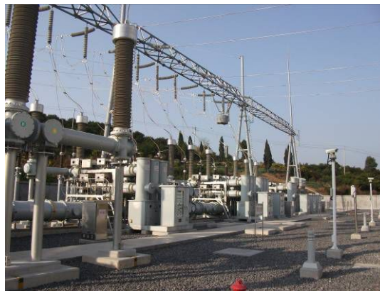
图 4-3 变电站 220kV 配电装置
