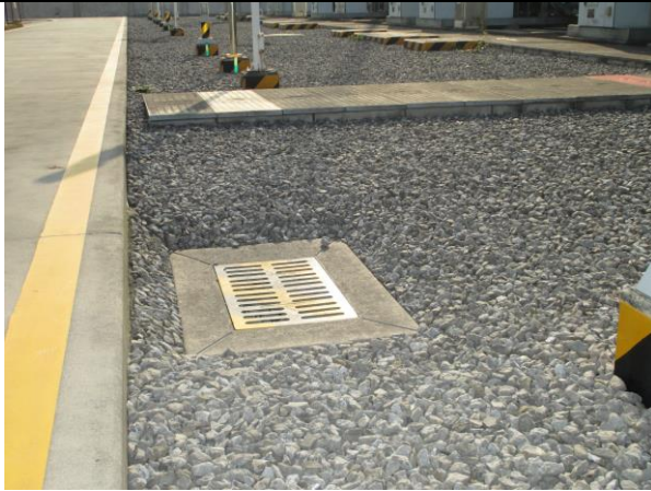
站内雨水收集井
