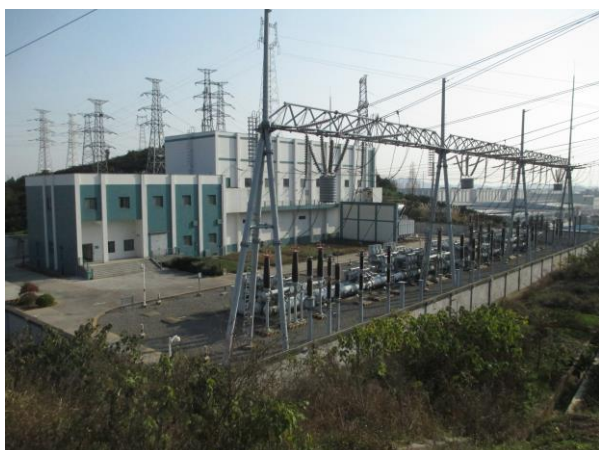
车站 220 kV 变电站
