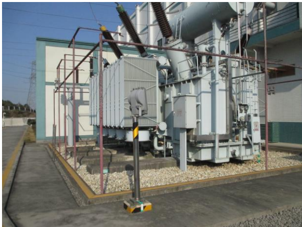
1#主变、油坑及隔音墙
