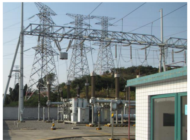
220kV 集电线路装置
