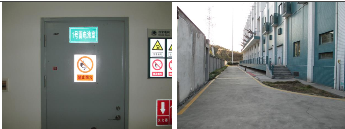
站内蓄电池室
