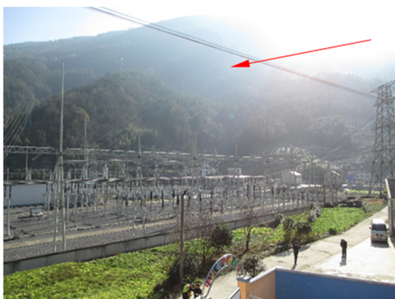
220kV 五峰变电站扩建间隔侧
