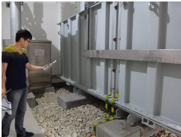
110kV 东湖变站内主变及下方卵石照片
