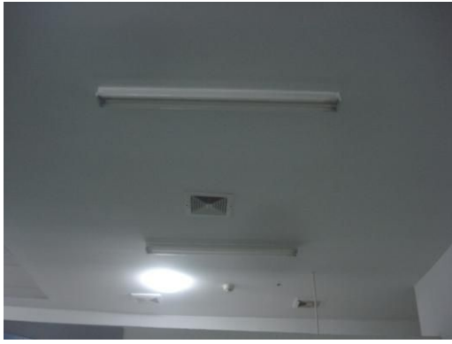
直线加速器治疗室上进风口
