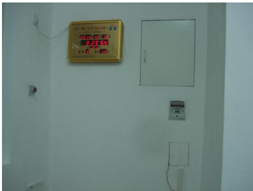
直线加速器治疗室固定式报警器
