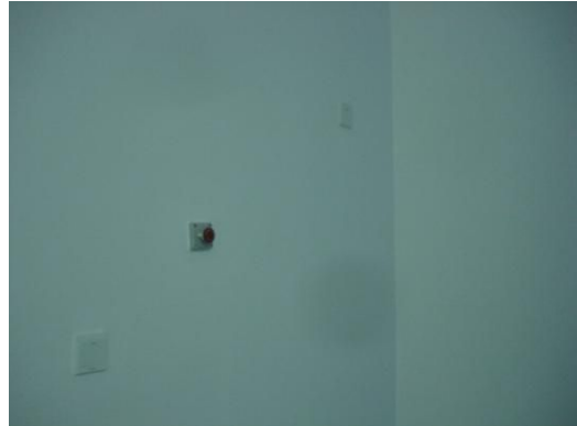
直线加速器室内应急按钮
