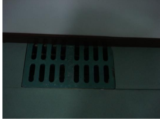
直线加速器治疗室下出风口
