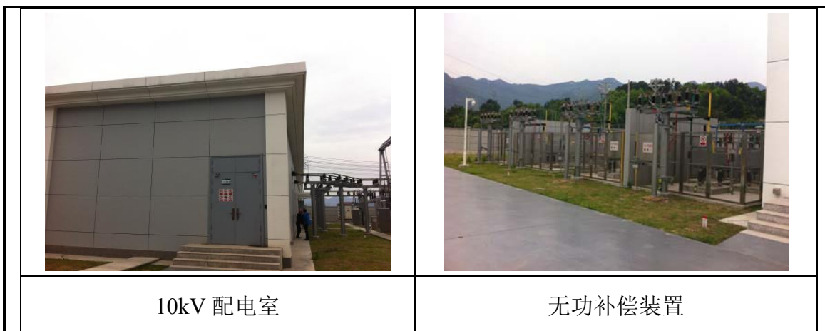
图 4-2 金缸城变电站本期工程主要设备情况
