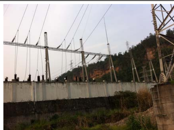
220kV 点军变间隔扩建侧
