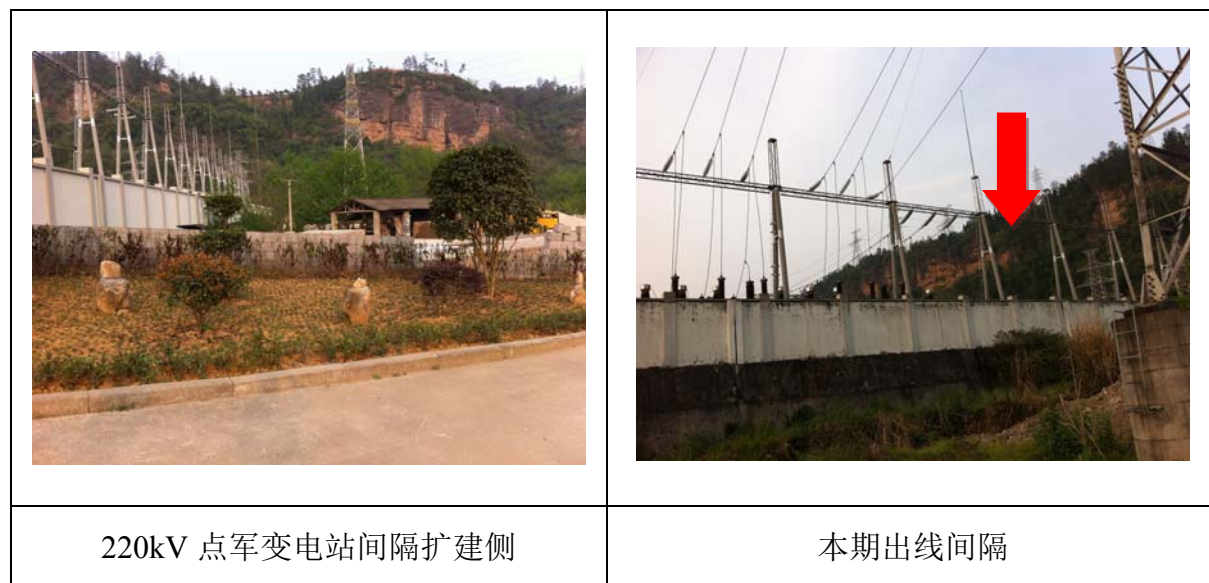
图1-4 220kV 点军变电站间隔扩建侧照片
